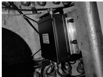
图5 永州市某风场螺栓监测系统通讯控制器现场安装图
